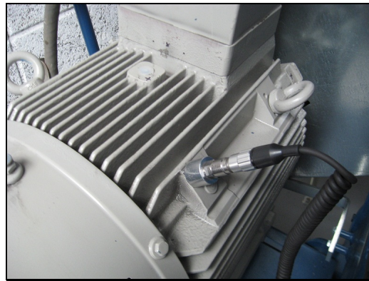
Fig. 3.2: Plaatsing trillingsopnemer op e-motor.
